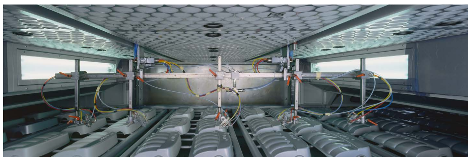
Leuchten der Baureihe e192 ... eingebaut unter räumlich beengten Verhältnissen in einer Lackierstraße für Kleinteile.
